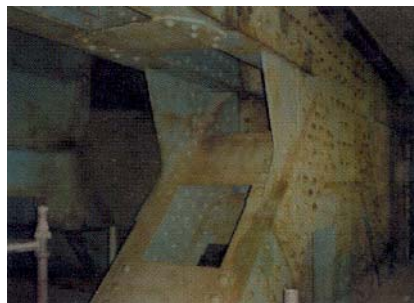
Состояние металла до начала работ.
